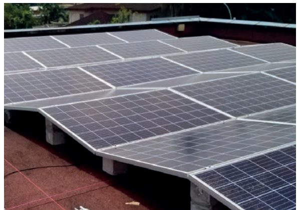
Ecobank Cote d'Ivoire: Solar panels at the Rue des Jardins branch
